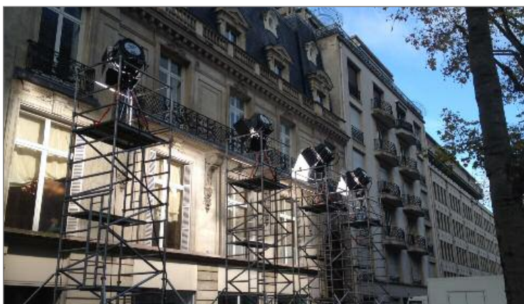
Les Alpha 18 kW devant les fenêtres d'un immeuble parisien
